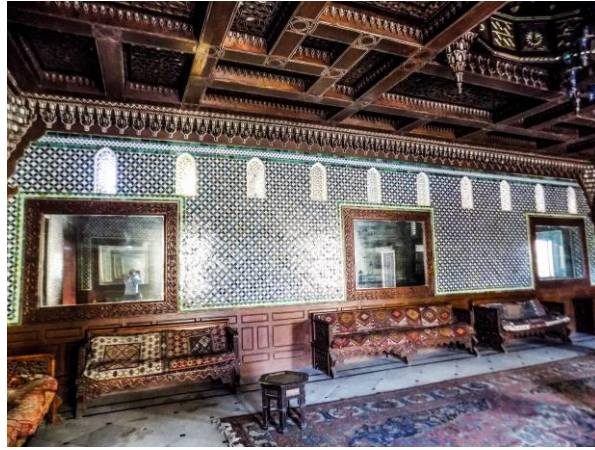
لوحة (٤٧) : تكسيات الزليج بجدران القاعة المغربية من سراي الاستقبال بقصر محمد علي بالمنيل .
