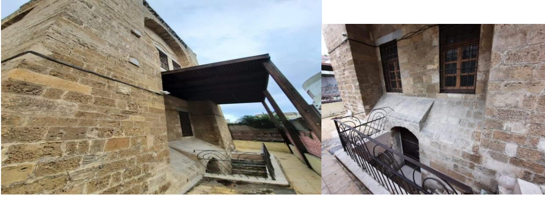
لوحة رقم (٦) الحائط الشمالي من الواجهة الشمالية لقصر آل رضوان ويظهر بها مدخل السجن الخاص بالرجال ونوافذ الطابق الأرضي التي تعلو المدخل ، والسقيفة الحديثة التي تعلو مدخل السجن للحماية من الأمطار
